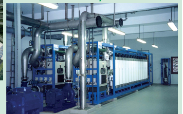
Ultrafiltration - Usine d'eau potable de PONT DE PIERRE (74) Syndicat de La Fillière
