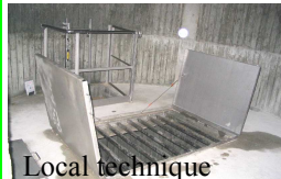
Rejet eaux pompage
