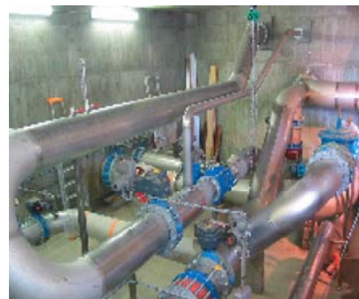
Chambre de pompage
